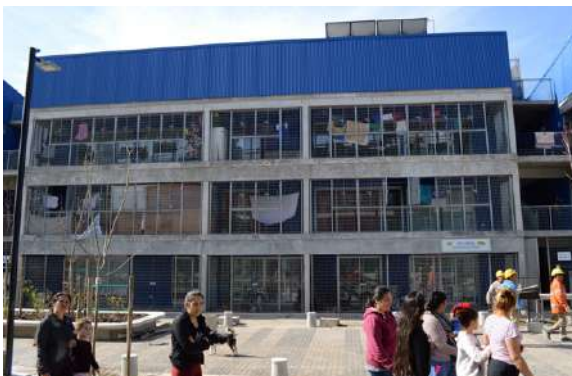
Figura 19. a) Vista general del conjunto habitacional en construcción. Se observan los paneles interiores y parte de los paneles exteriores a los que se les coloca aislante y tienen como revestimiento la chapa acanalada. La recova de planta baja está destinada a locales comerciales o a expansión de las viviendas. b) Vista general de la parte posterior en construcción en donde se observa la generación de una espalda como propuesta urbana. c y d) Vista general actual.
