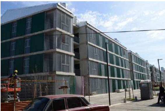
Figura 26. Vista exterior de los dos conjuntos habitacionales. Nótese el aspecto del hormigón visto en las vigas. En parte se debe a fallas en el encofrado que derivaron en revoques en distintos momentos que se han coloreado dando aspecto de deterioro en muy poco tiempo.
