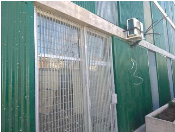
Figura 36. Detalle de perforaciones en los paneles por la colocación de equipos de aire acondicionado. Se observa el estado de los paneles exteriores con salpicaduras de material.
