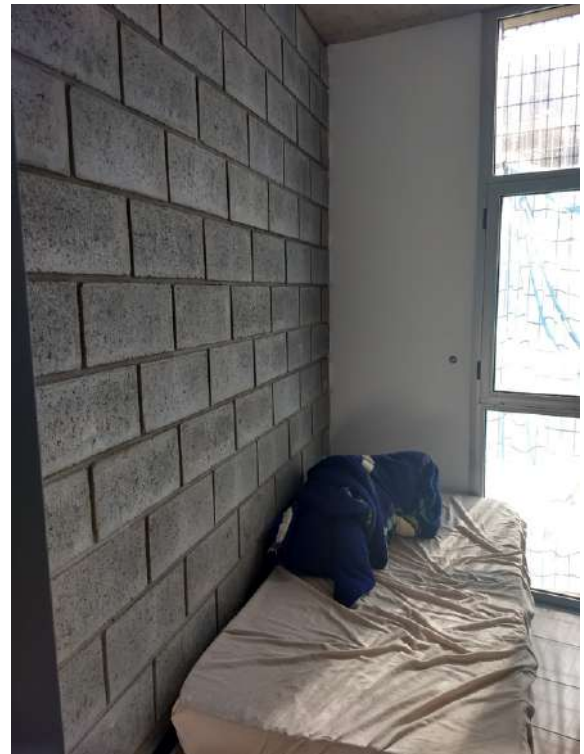
Figura 28. Detalle de posición de la cama que queda muy próxima a la puerta de acceso y no tiene adecuado respaldo dado que en el otro sentido no puede colocarse porque quedaría la cabecera pegada al panel de calefacción y no se podría transitar transversalmente. El gesto proyectual del ángulo no permite un adecuado aprovechamiento del espacio.
